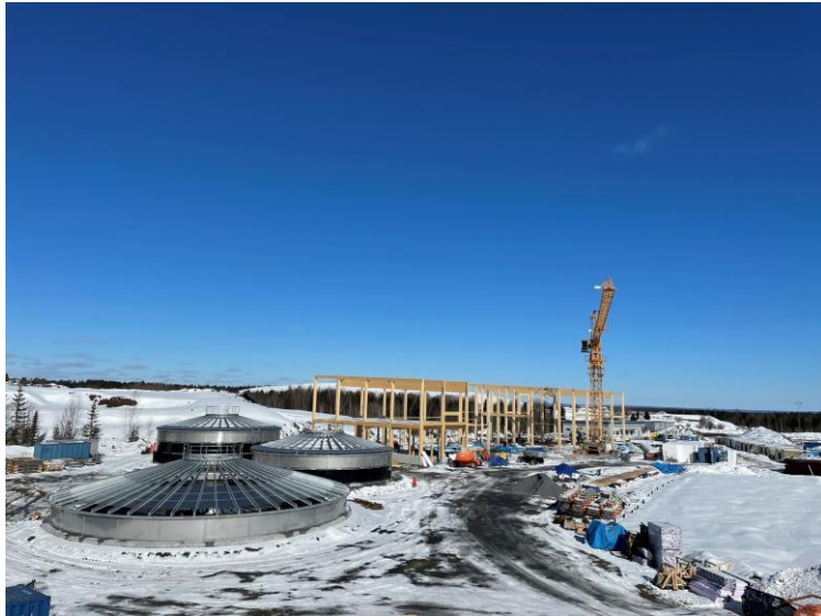
Utvändiga tankar, RRL närmast i bild
