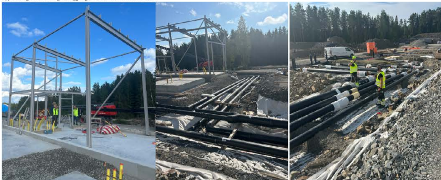
Stomme-platta värmepanna. Fjärrvärmeledningar.
