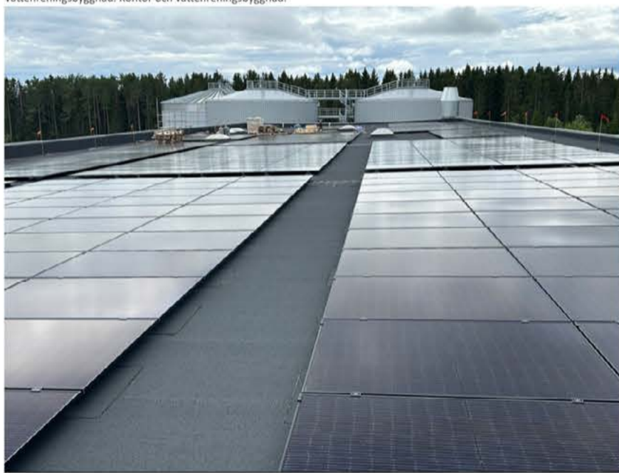
Solpaneler processbyggnad. Röttankar och biogödseltank i fonden.
