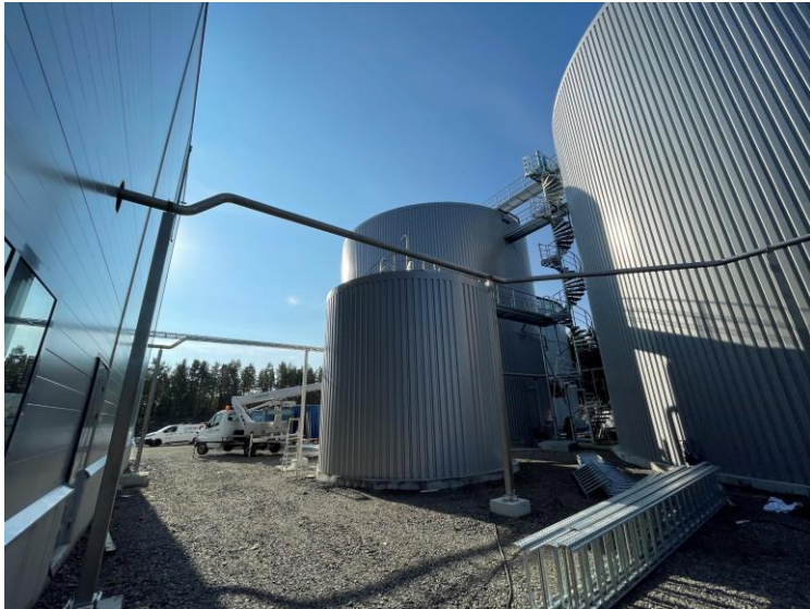
Utvändigt ledningsmontage på tankar
