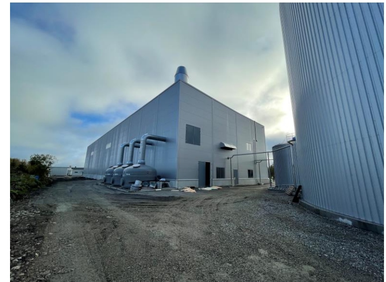
Ventilationskanaler mot kolfilter
