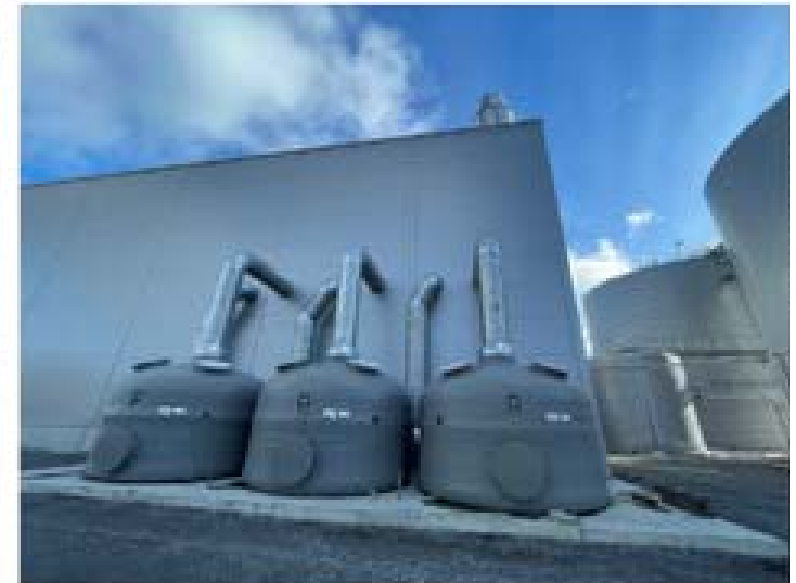
Ventilationskanaler till kolfilter
