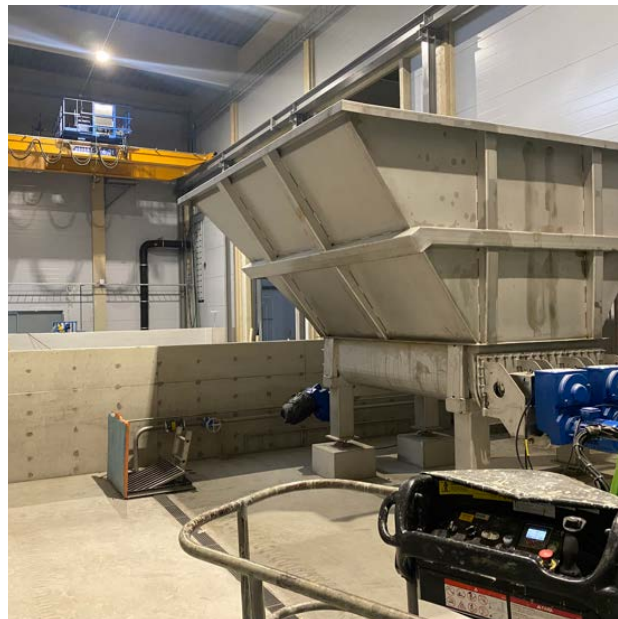
Matavfallsficka samt mottagningstratt till förbehandling.
